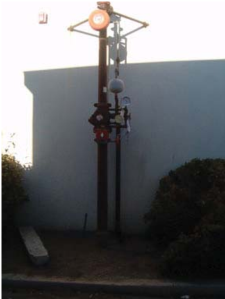
Fire Sprinkler Riser
