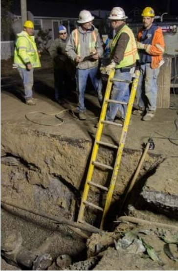
Figura 13-8: El personal de gas natural desconecta el gas después del huracán Sandy.
