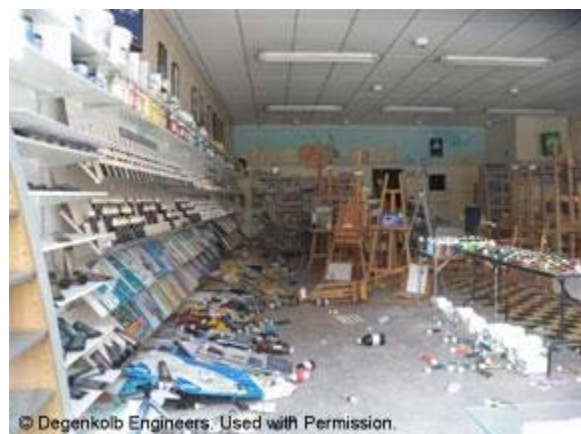
Figura 12-5: Daños no estructurales importantes dentro de un edificio que tenía una estructura estable luego de un evento de terremoto
