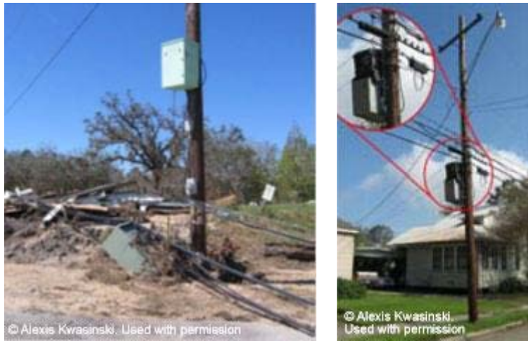
Figura 15-6: La ubicación de los sistemas de SAI es una consideración importante para la resiliencia y el mantenimiento periódico
