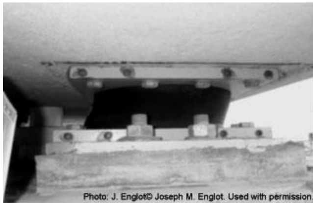
Figura 13-11: Soporte de aislamiento sísmico del tren aéreo
