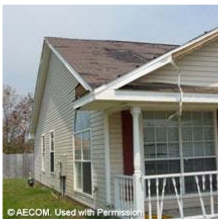
Figura 12-4: Daños en la cubierta del techo, al revestimiento vinílico y al salpicadero como resultado del viento
