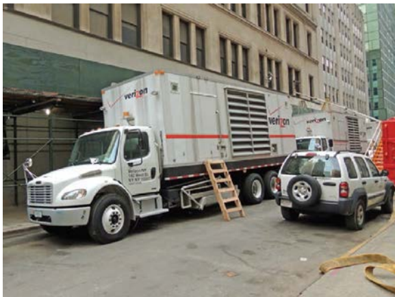
Figura 15-3: Unidad de energía portátil de reserva grande que se utiliza cuando fallan los generadores del sótano [Fuente: FEMA 2013]
