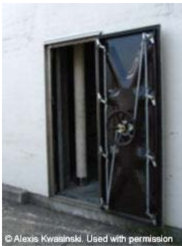
Figura 15-7: Puerta estanca utilizada en la central telefónica en Kamaishi, Japón
