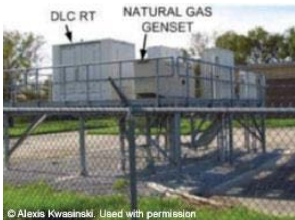
Figura 15-5: DLC RT elevada con generador de reserva de gas natural instalado después del huracán Katrina
