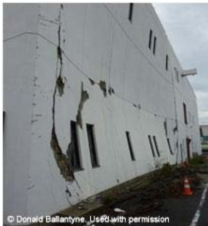
Figura 16-13: El tsunami del terremoto de Tohoku en 2011 dañó la estación de bombeo de efluentes de la WWTP en Sendai
