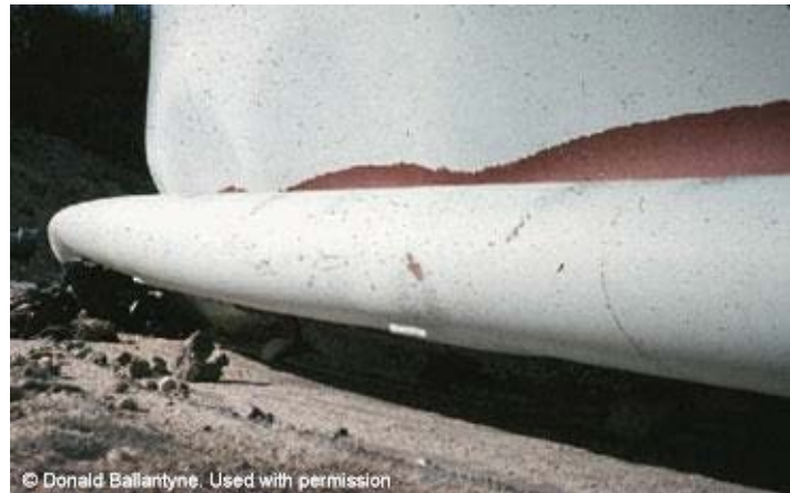
Figura 16-8: Abolladuras en la base de un tanque de acero en el terremoto de Northridge en 1994
