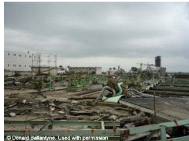
Figura 16-14: Daños en los equipos y tuberías de la WWTP por el terremoto de 2011
