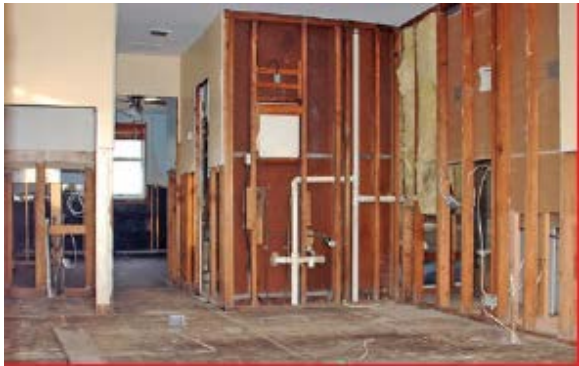
Figura 12-6: Como resultado de una inundación estimada de 0,9-1,2 m (3-4 pies), se tuvieron que reemplazar las paredes interiores, así como también una puerta y ventana exteriores [Fuente: FEMA]
