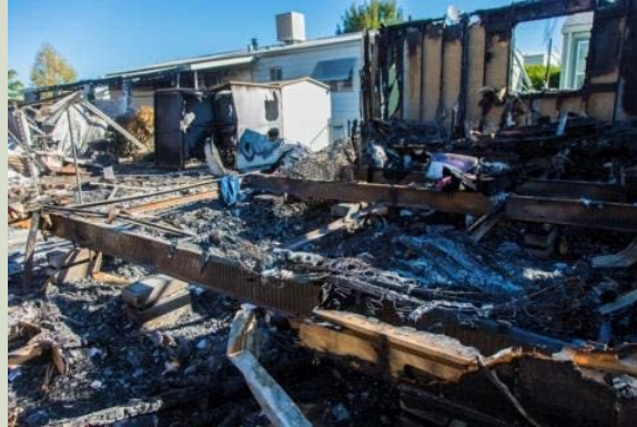
Figura 13-9: Daños causados por incendios debido a una rotura de tuberías de gas [Fuente: Christopher Mardorf, FEMA 2014]
