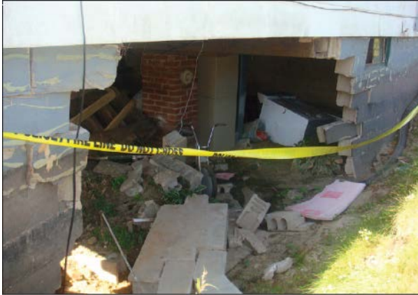
Figura 12-10: Derrumbe de las paredes de cimentación debido a la presión hidrostática de las aguas de la inundación [Fuente: FEMA]
