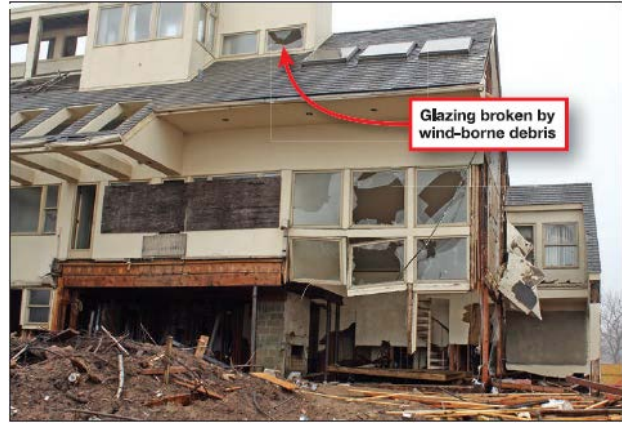
Figura 12-11: El viento y los escombros causados por el viento generaron daños importantes en los cristales de este edificio [Fuente: FEMA]
