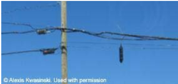
Figura 15-4: Falla del cable de televisión por antena comunitaria (CATV, por sus siglas en inglés) debido a los efectos del viento
