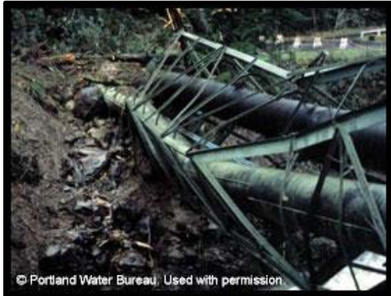
Figura 16-2: Puente de la tubería de transmisión de agua dañado por el deslizamiento de tierra
