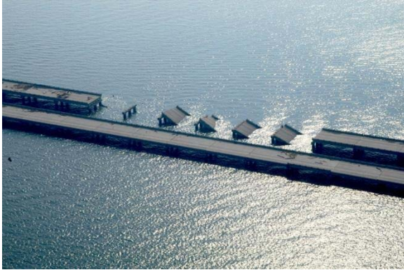
Figura 13-3: Secciones del puente que se desprendieron de sus soportes durante el huracán Katrina debido a la acción de las olas (Fuente: foto tomada por Win Henderson [FEMA 2014d])
