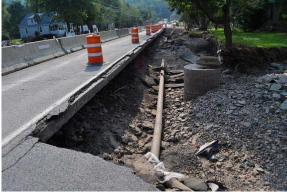
Figura 13-1: Descalce de carreteras tras el paso del huracán Irene (Fuente: foto tomada por Elissa Jun [FEMA 2014a])
