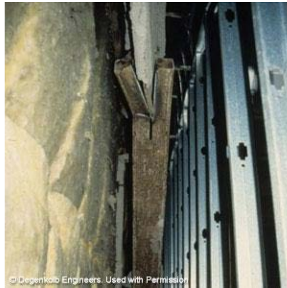
Figura 12-9: Conexiones de tirantes fracturadas en un edificio dañado en un terremoto
