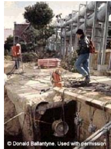
Figura 16-12: Canal de la WWTP de Higashinada desplazado por la licuefacción en el terremoto de Kobe de 1995
