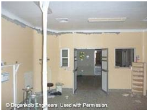
Figura 12-2: Daños no estructurales en los acabados interiores luego de un evento de terremoto
